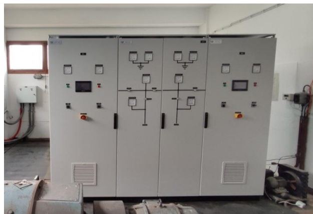
Слика 2. Ново постројење за напајање електролизера
